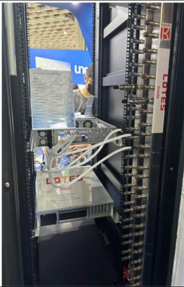
圖 55: 晟銘電 42U 水冷機櫃與多家零組件廠商合作
